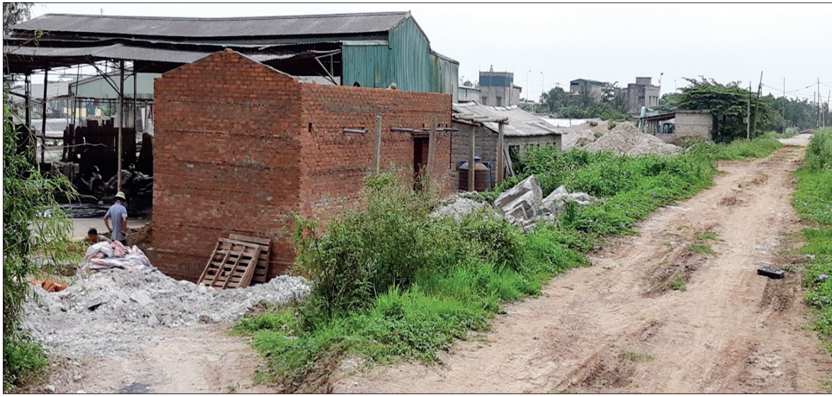
Công trình xây dựng vi phạm hành lang bảo vệ đê tại xã An Ninh được huyện Quỳnh Phụ phát hiện, xử lý.
