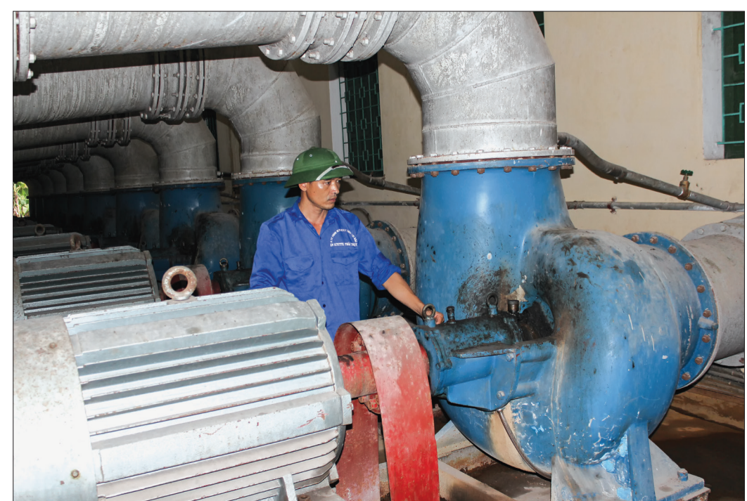
Hệ thống máy bơm tại trạm bơm Hệ được định kỳ bảo dưỡng bảo đảm vận hành tốt.
