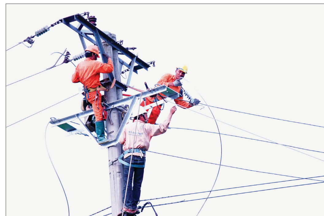
Cải tạo, nâng cấp lưới điện tại xã Nam Bình (Kiến Xương).
