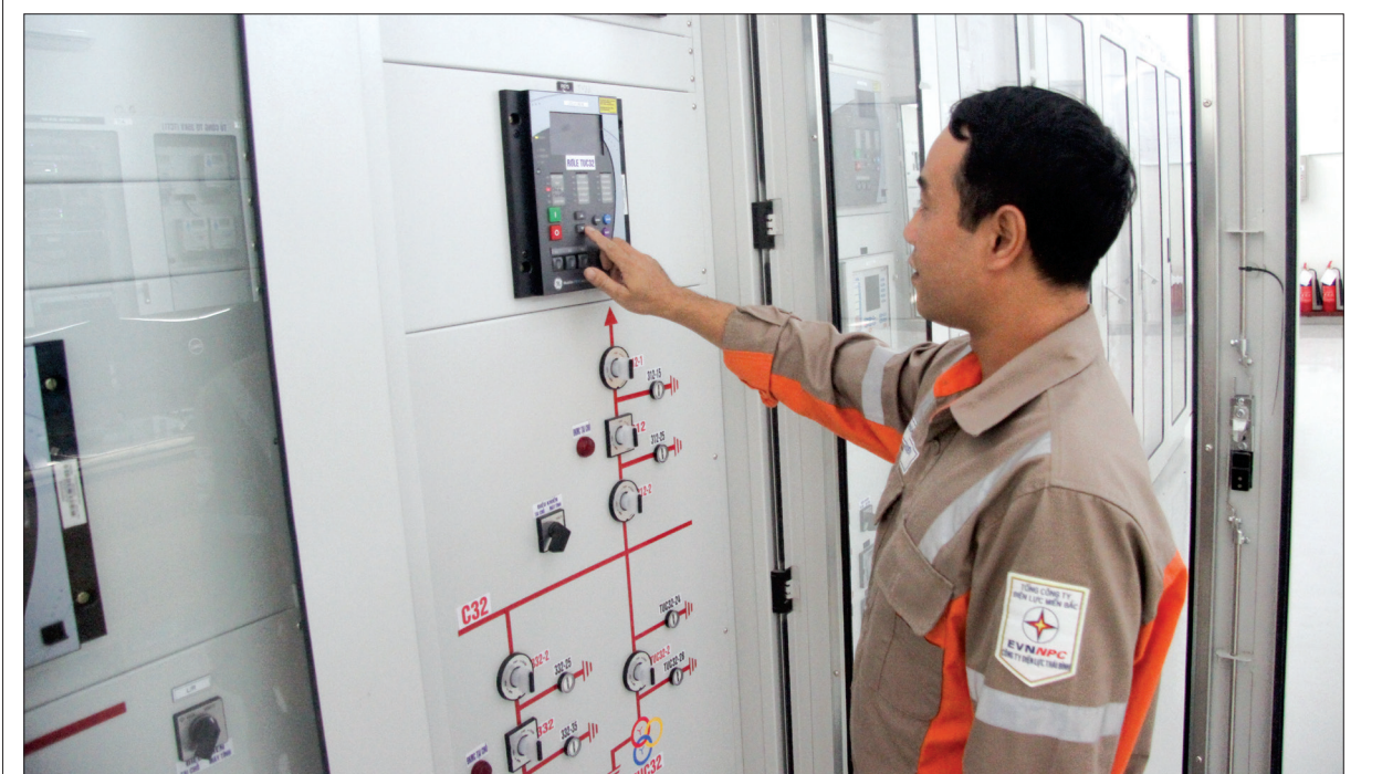
Công nhân Công ty Điện lực Thái Bình kiểm tra hệ thống cấp điện ổn định phục vụ công tác tưới, tiêu sản xuất vụ xuân.
