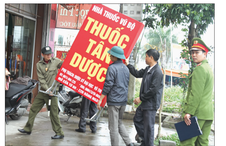
Lực lượng chức năng huyện hỗ trợ người dân thu dỡ biển quảng cáo vi phạm hành lang an toàn giao thông.
