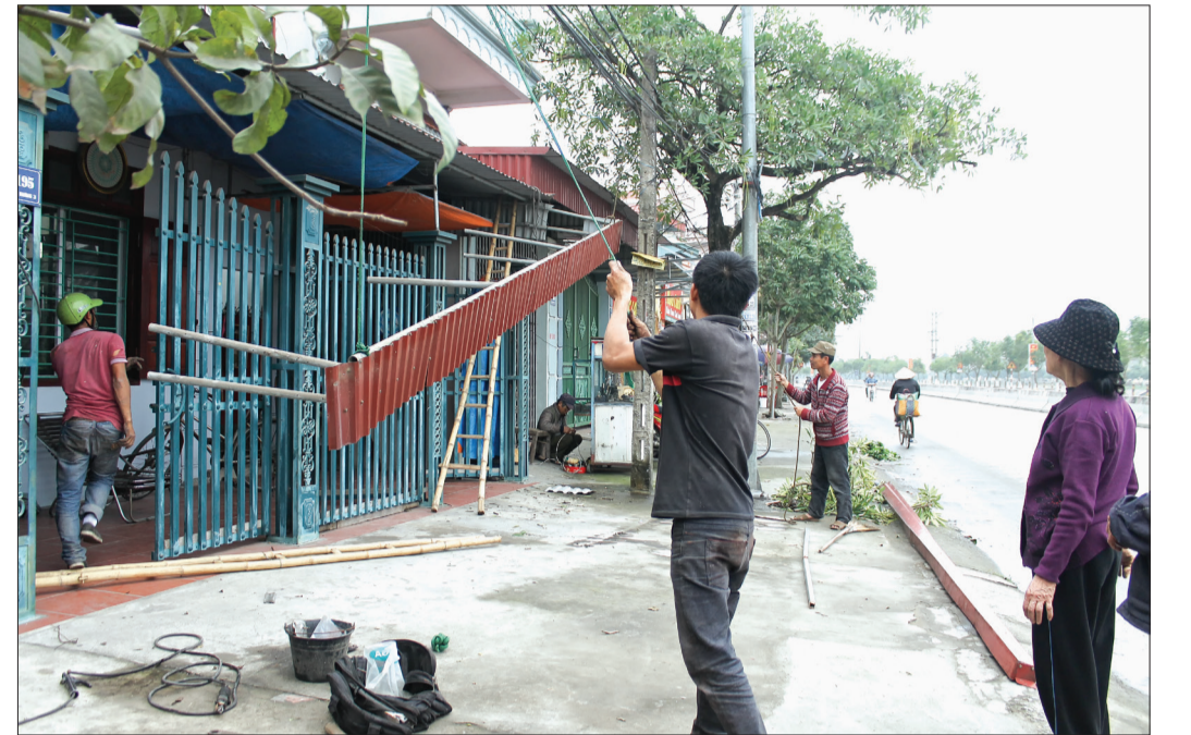
Nhiều gia đình tự giác tháo dỡ mái đua vi phạm hành lang an toàn giao thông.
