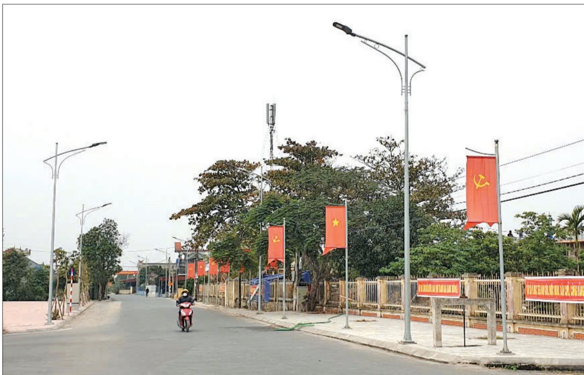
Tất cả trục đường tại xã An Tràng (Quỳnh Phụ) đều lắp đặt điện chiếu sáng, góp phần nâng cao chất lượng cuộc sống người dân.
