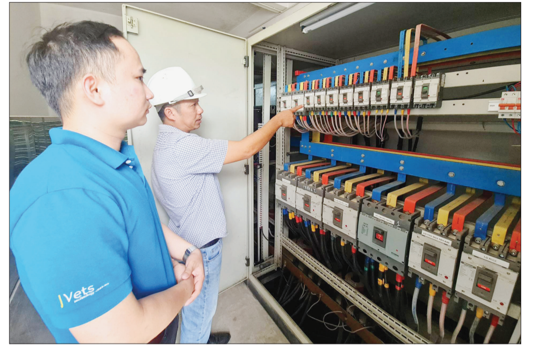
Cán bộ phòng cơ điện làm việc tại trung tâm điều khiển điện toàn bộ các nhà máy sản xuất của Công ty Cổ phần Quốc tế Bảo Hưng.
