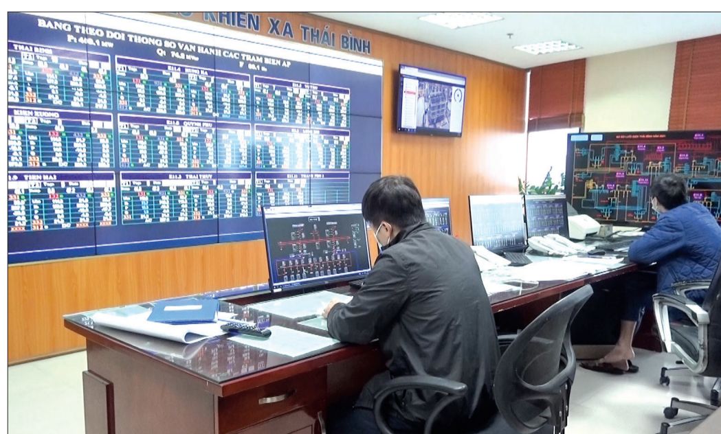
Nhân viên Trung tâm điều khiển xa của Công ty Điện lực Thái Bình theo dõi hoạt động của các trạm biến áp 110kV không người trực bảo đảm cấp điện ổn định, an toàn.
