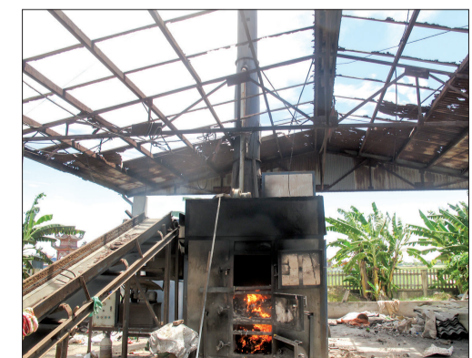
Lò đốt rác xã Thái Xuyên sau 4 năm hoạt động đã xuống cấp.
