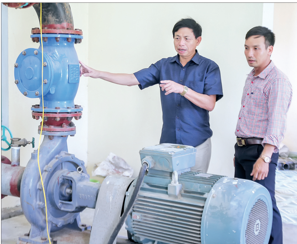
Ông Đỗ Chí Lệ, Chủ tịch Hội đồng quản trị kiêm Giám đốc Công ty Cổ phần Thương mại Thành Đạt kiểm tra vận hành nhà máy nước An Đông (Quỳnh Phụ).
