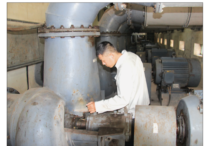
Công nhân trạm bơm Thống Nhất (Tiền Hải) kiểm tra máy bơm trước khi vận hành.
