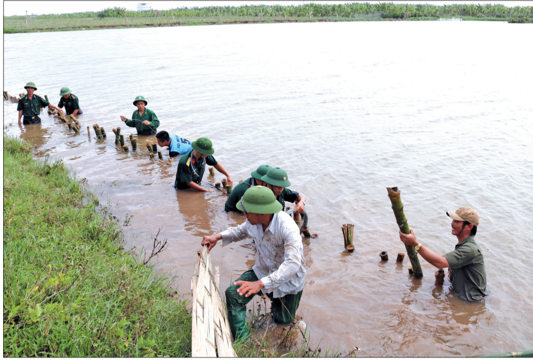
Lực lượng chức năng xử lý sự cố sạt lở má đê phía đông tuyến đê biển số 5 đoạn qua địa phận xã Nam Phú (Tiền Hải).
