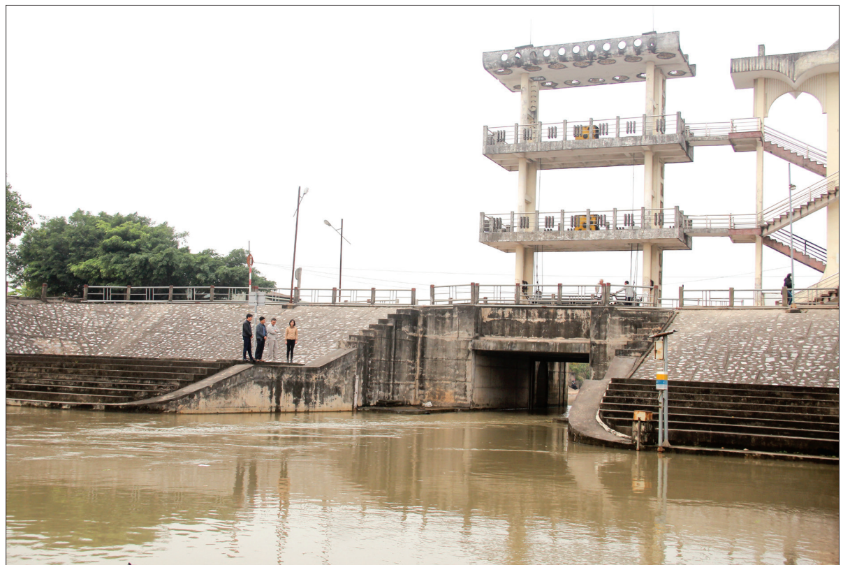
Công Tân Đê mở tối đa khai thác tối nguồn nước dự trữ vào hệ thống.
