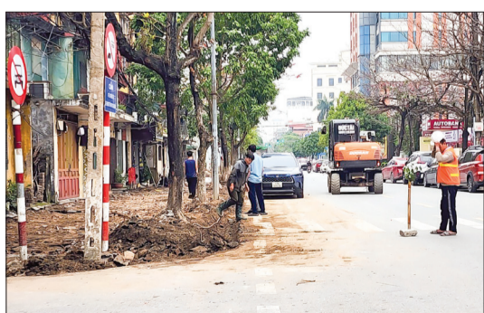
Cải tạo, sửa chữa vỉa hè đường Trần Hưng Đạo (thành phố Thái Bình).
