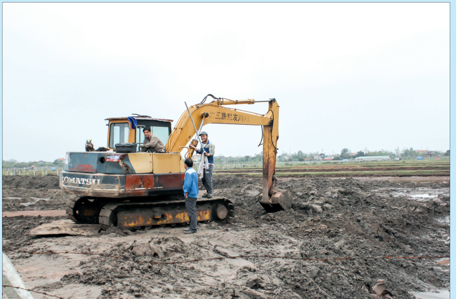
Hộ nuôi trồng thủy sản xã Thái Thượng (Thái Thụy) gia cố, tôn cao bờ bao nuôi thủy sản.
