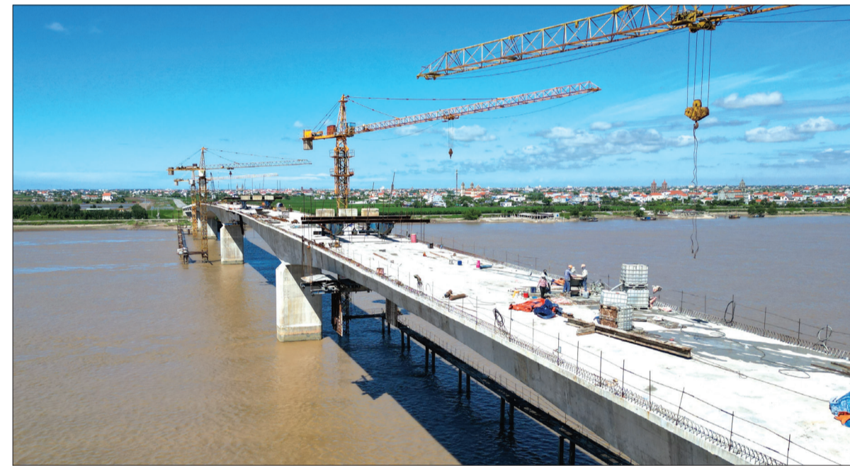
Thi công công trình cầu vượt sông luồn tiềm ẩn nguy cơ mất an toàn mùa mưa bão. Do đó, công tác bảo đảm an toàn luôn được chủ đầu tư và đơn vị thi công đặt lên hàng đầu.
