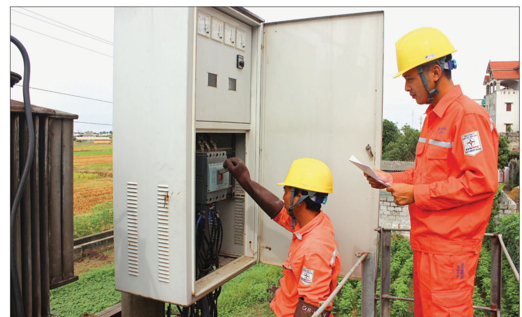
Công nhân Công ty Điện lực Thái Bình kiểm tra máy biến áp bảo đảm điện ổn định.
