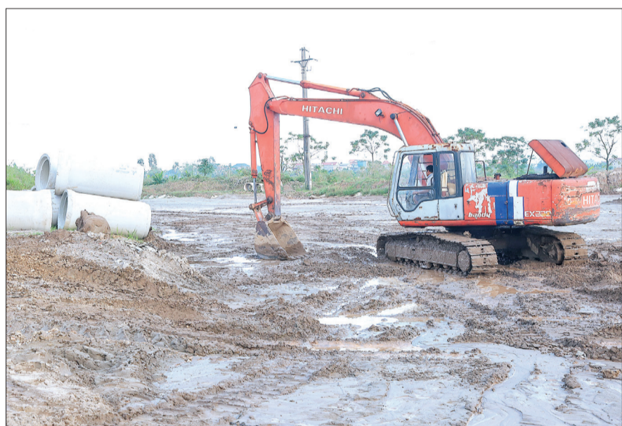
Tuyến đường từ thành phố Thái Bình đi cầu Ngành đoạn qua huyện Quỳnh Phụ đang được thi công. Ảnh: NGỌC LINH
