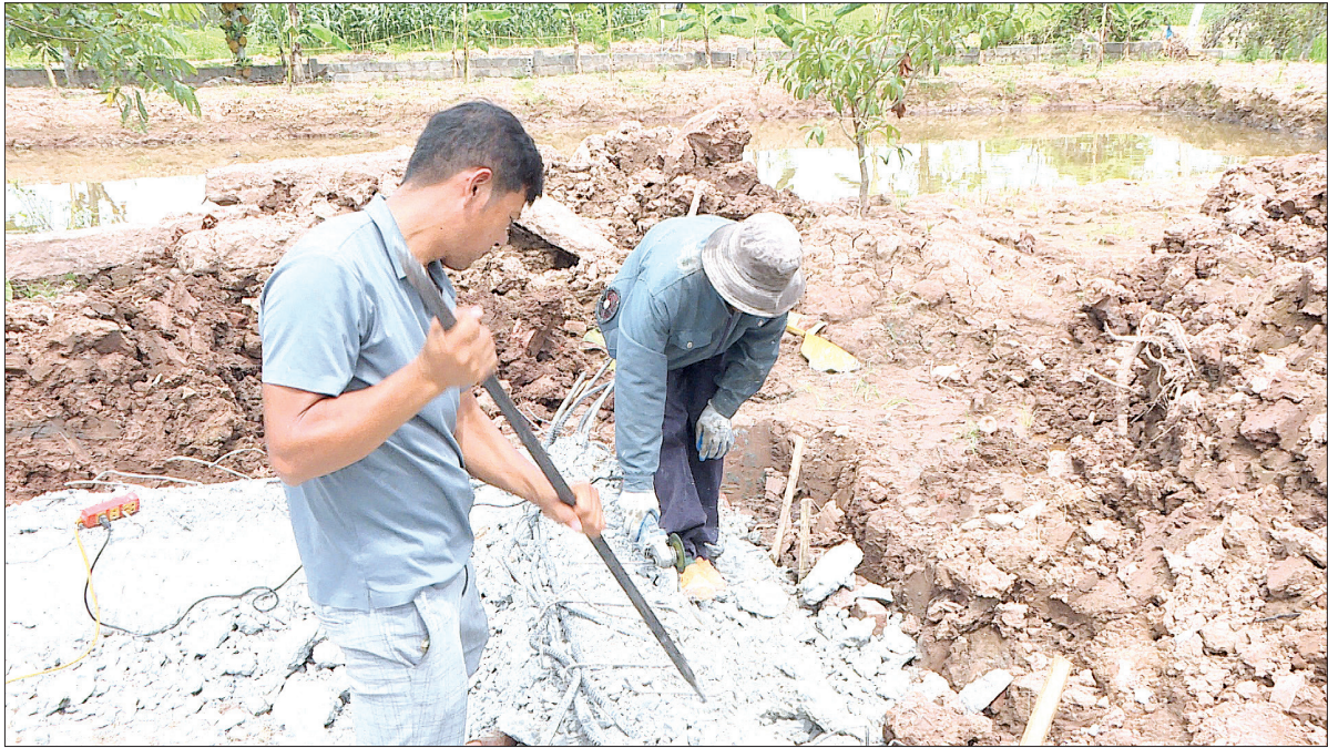
Sau khi UBND xã lập biên bản, anh Đào Văn Quyền tự nguyện tháo dỡ công trình xây dựng trái phép trên đất nông nghiệp ở xã Phong Dương Tiến (Đông Hưng).
