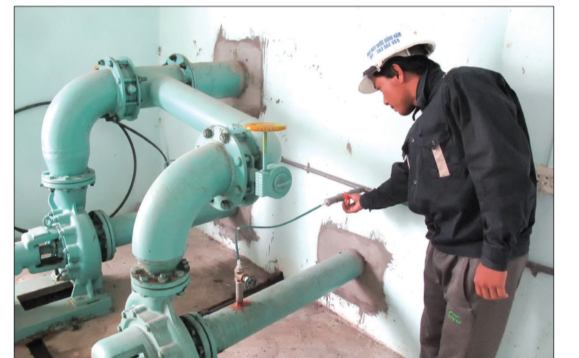
Công nhân vận hành máy bơm tại nhà máy nước sạch của Công ty TNHH Thương mại Đồ Gia Bảo.
