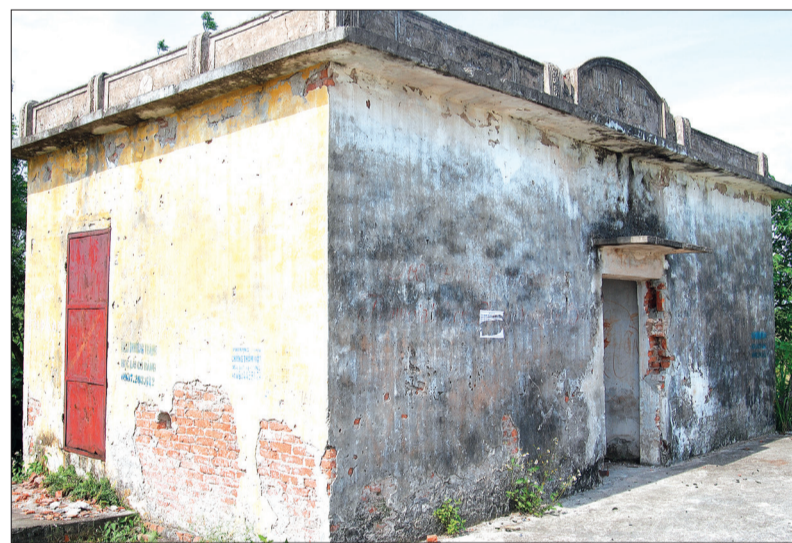
Điểm canh dê số 2 xã An Bình (Kiến Xương) bị bong tróc vữa, thấm dột và mất cánh cửa.
