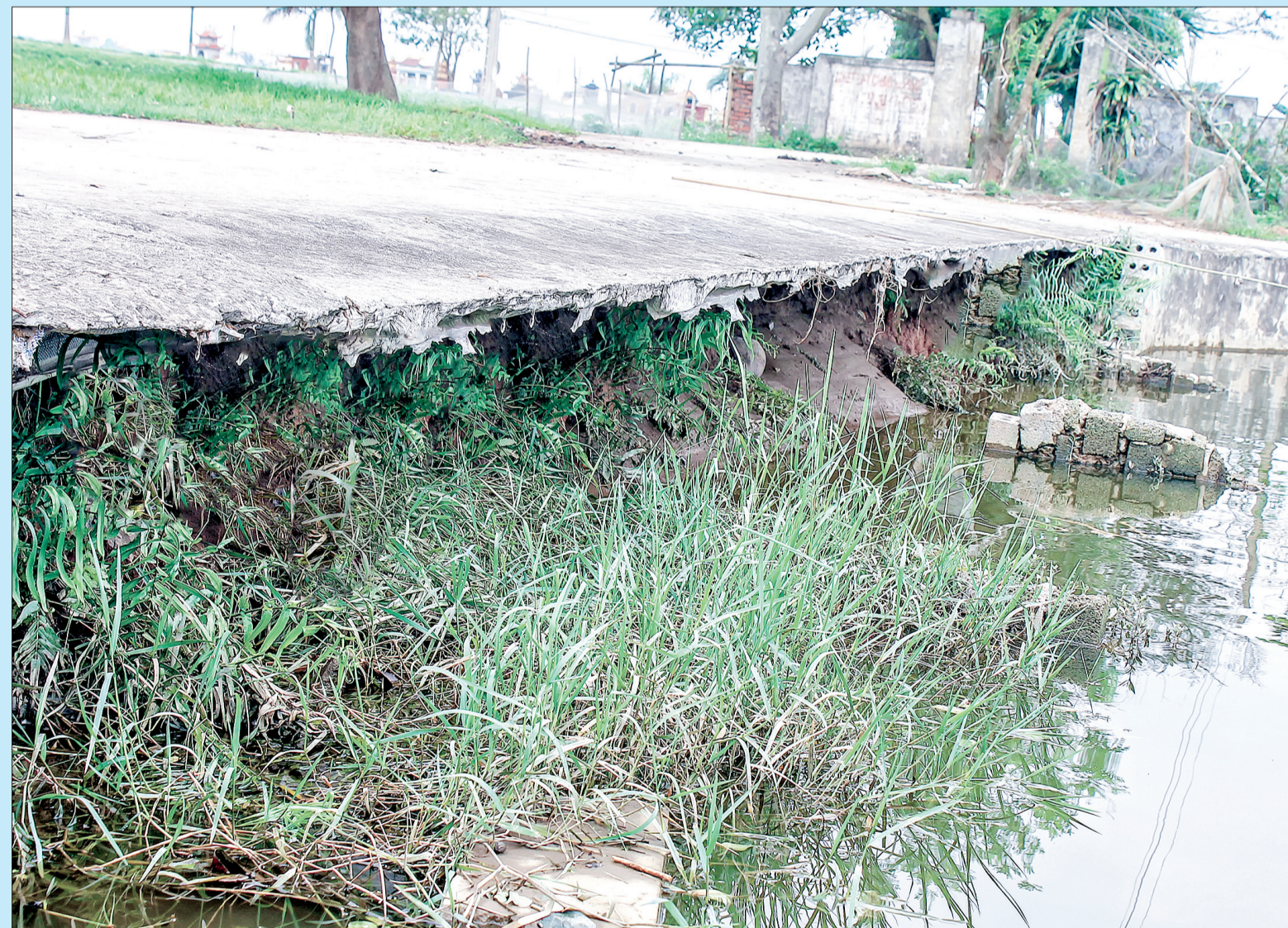
Đoạn đường nhánh vào hội trường thôn Nam Long, xã Tự Tân có kè ao đã sạt lở.
