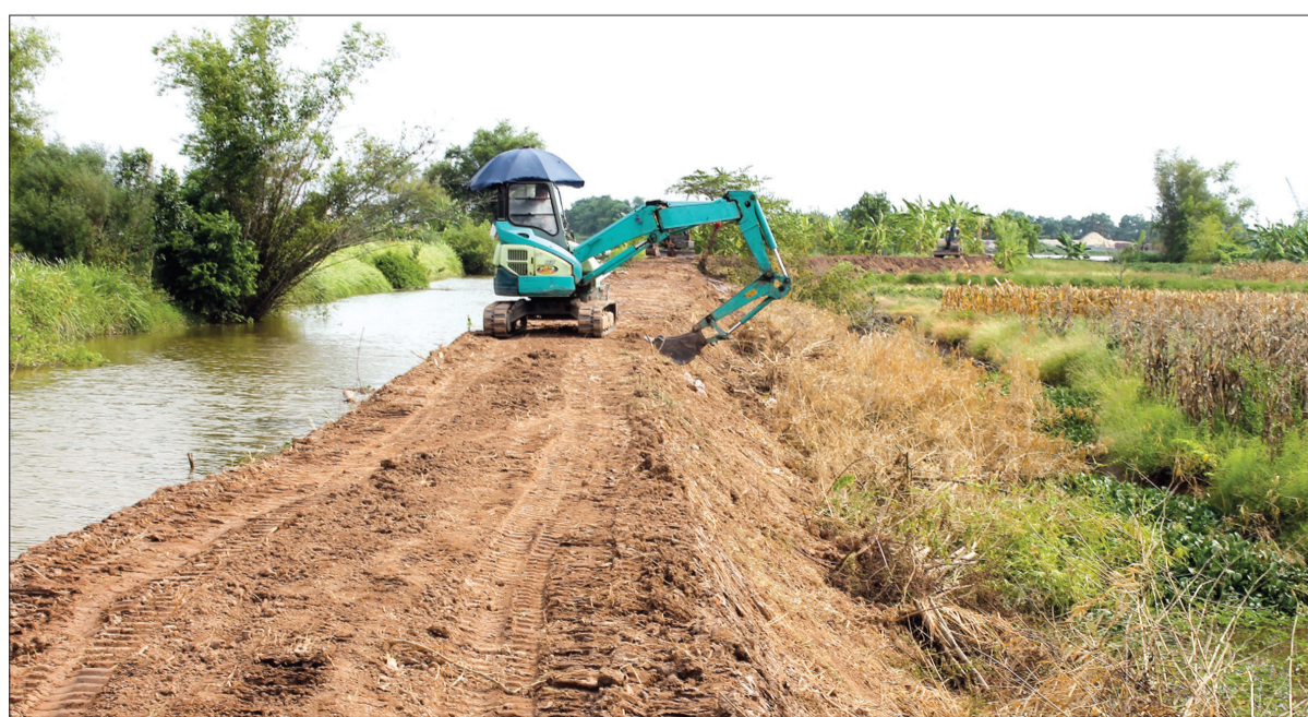
Xã Vũ Văn tiến hành tu bổ, gia cố đê bao vùng màu ở các đoạn xung yếu trong mùa mưa bão năm 2023.
