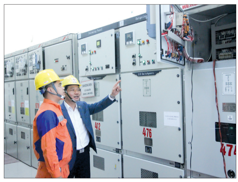
Công nhân Công ty Điện lực Thái Bình làm chủ thiết bị máy móc hiện đại bảo đảm cung cấp điện ổn định, an toàn phục vụ nhiệm vụ phát triển kinh tế - xã hội.
