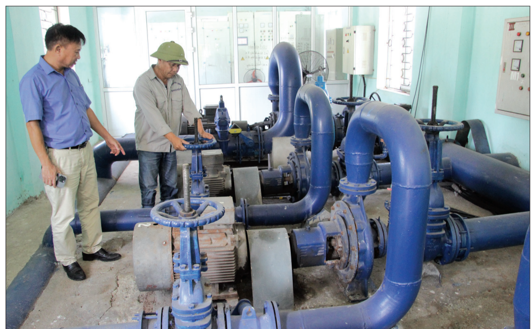
Công nhân Xí nghiệp nước Tiên Hải kiểm tra hệ thống bơm áp lực nước.
