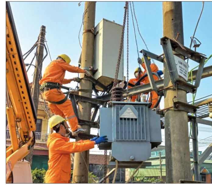
Điện lực Vũ Thư thường xuyên đầu tư nâng cấp hạ tầng lưới điện.
