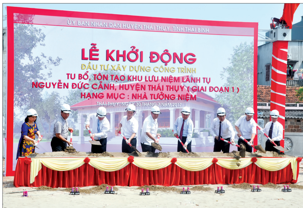
Các đồng chí lãnh đạo thực hiện nghi lễ khởi động công trình.
