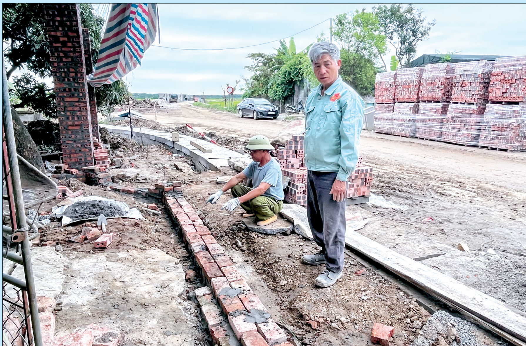
Người dân xã Đông Tiến (Quỳnh Phụ) xây dựng lại tường bao, cổng dậu sau khi tự nguyện phá dỡ, hiến đất làm đường ĐT.455.
