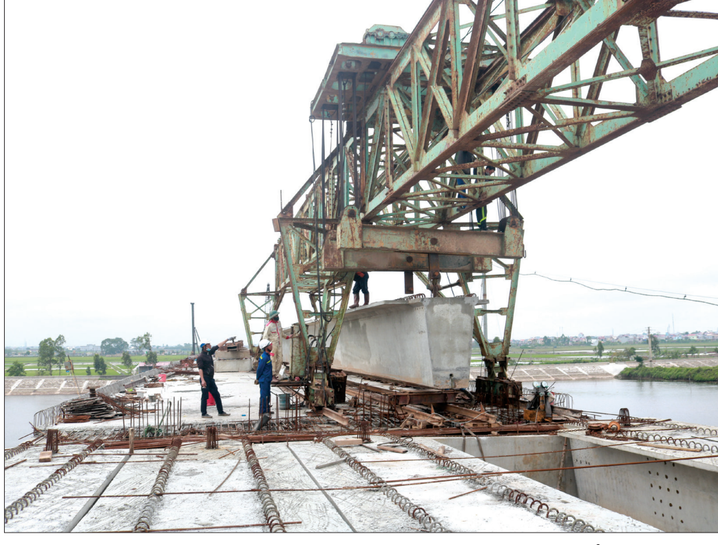
Thi công cầu Diêm Điền thuộc dự án đầu tư xây dựng tuyến đường bộ ven biển tỉnh Thái Bình.
