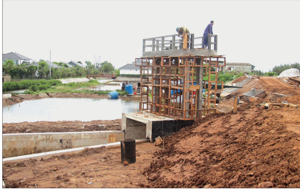
Cống Muối đang được đơn vị thi công tập trung xây dựng, phấn đấu hoàn thành theo kế hoạch.
