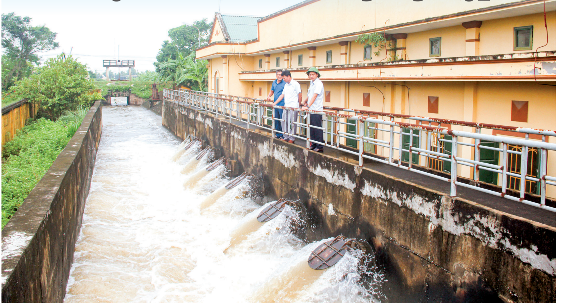
Trạm bơm Đông Tây Sơn thuộc hệ thống thủy lợi Nam Thái Bình vận hành hết công suất từ ngày 28/9.
