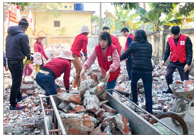
Cán bộ, tình nguyện viên chữ thập đỏ hỗ trợ Trường Mầm non Minh Tân (Đông Hưng) giải phóng mặt bằng, xây dựng công trình vệ sinh từ nguồn quỹ tiếp sức đến trường.
