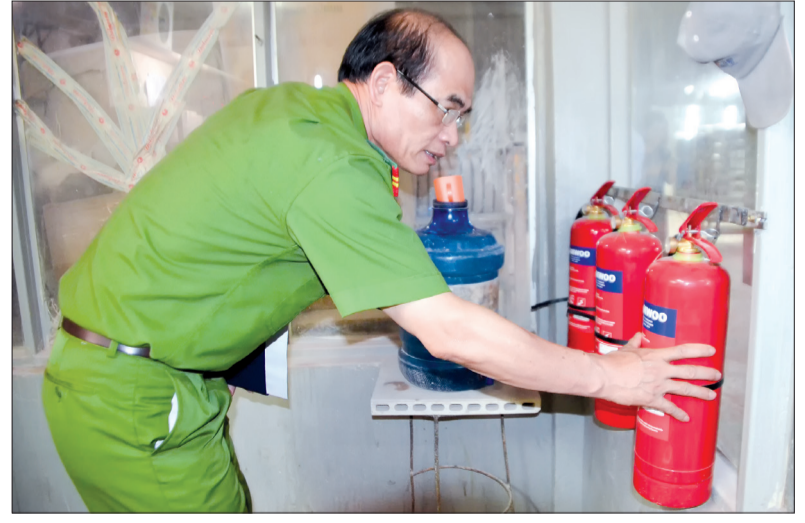
Kiểm tra tình trạng hoạt động của thiết bị chữa cháy tại Công ty TNHH Sứ Đồng Lâm.
