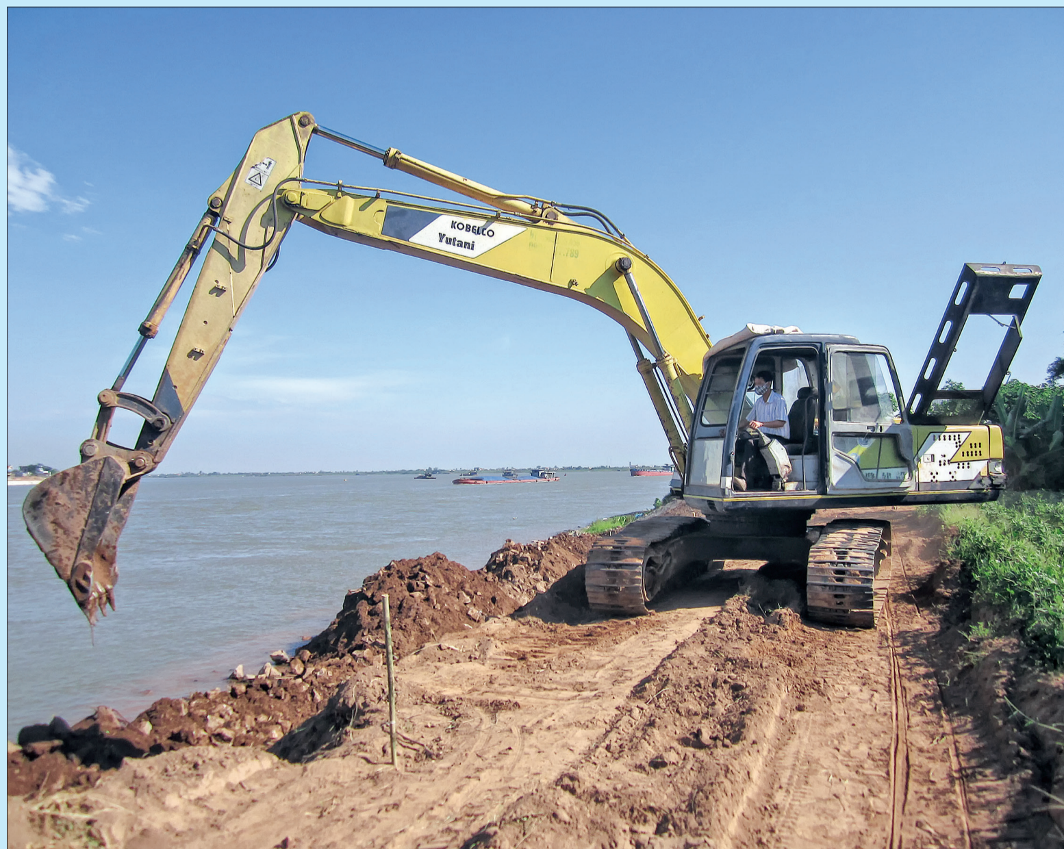
Xây dựng kè Hưởng Điển (Việt Hùng) nhằm bảo vệ tuyến đê Hồng Hà II qua địa bàn.
