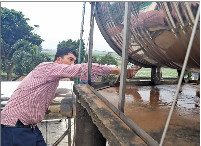
Anh Phạm Công Quyền, thôn Dục Dương Đông chỉ chỗ bốn inox đựng nước máy bị han, rỉ và cặn bẩn còn sót lại xung quanh bồn.
