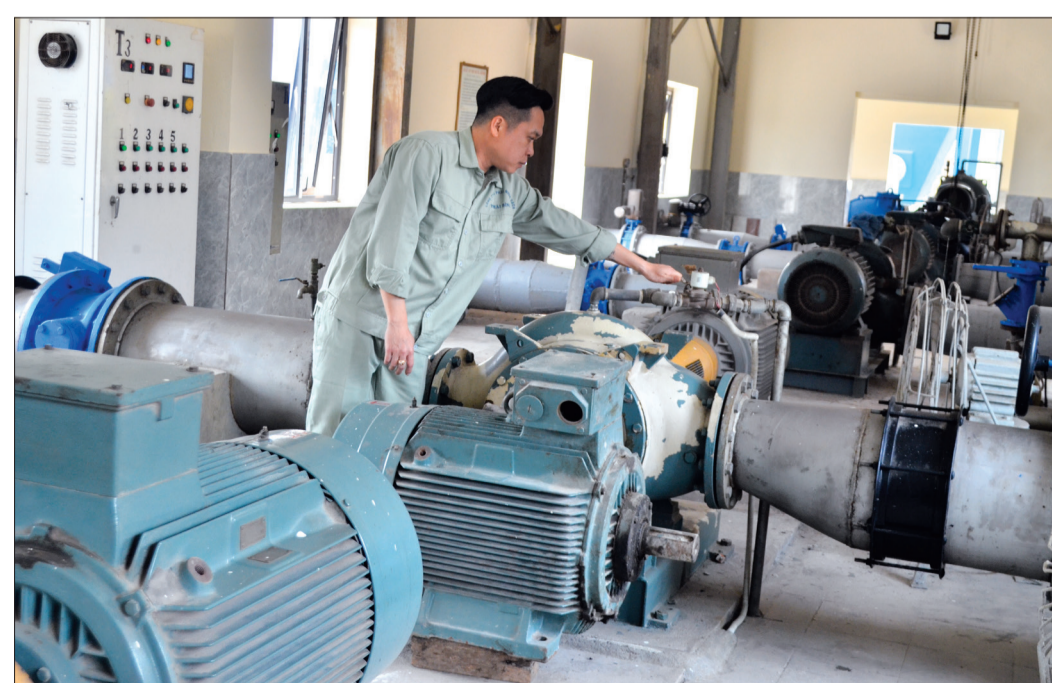
Công nhân Xí nghiệp nước thành phố vận hành hệ thống cấp nước.
