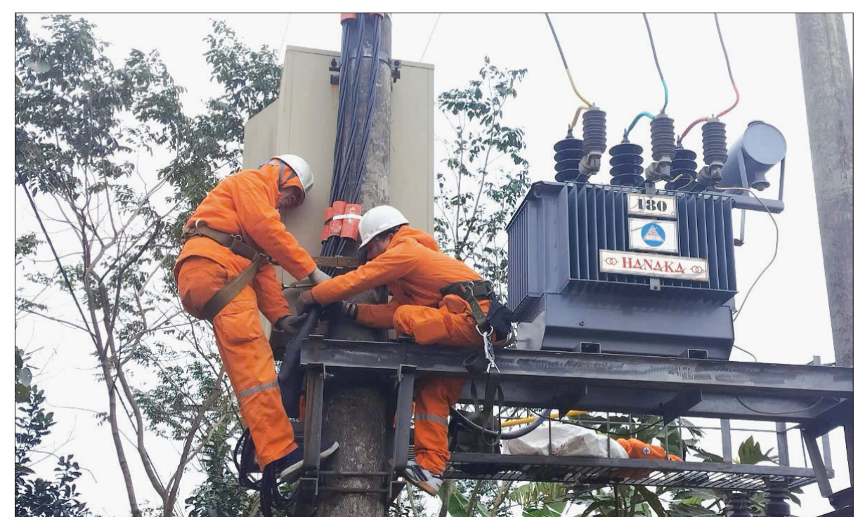
Công nhân Điện lực Kiến Xương kiểm tra, bảo đảm hoạt động ổn định của máy biến áp.
