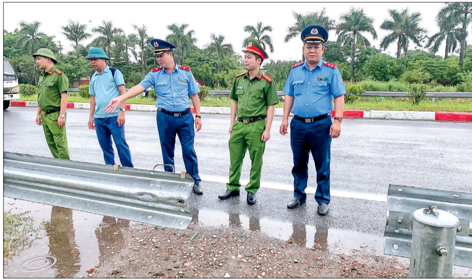
Lực lượng chức năng kiểm tra các điểm bị tháo dỡ trái phép tôn hộ lan trên tuyến đường vành đai phía Nam thành phố Thái Bình.
