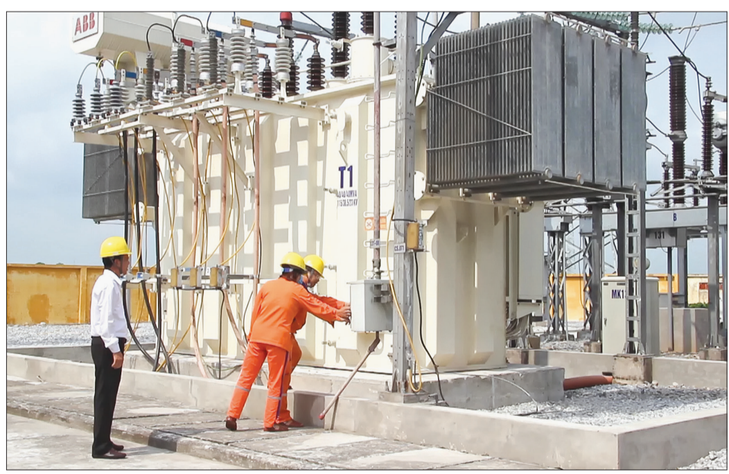
Công ty Điện lực Thái Bình đầu tư nâng cấp các trạm biến áp bảo đảm cung ứng điện ổn định, an toàn.
