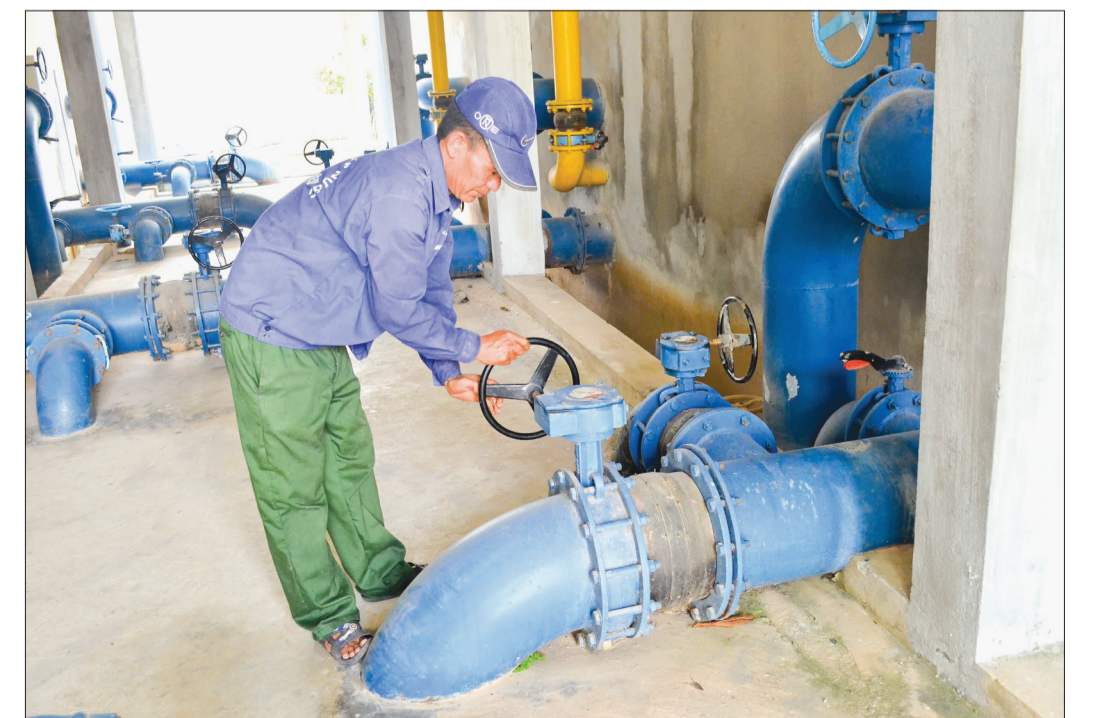
Công nhân Công ty Cổ phần Cấp nước Hoàng Diệu vận hành trạm bơm nước.
