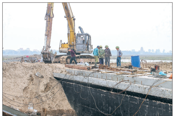
Thi công đường vành đai phía Nam thành phố Thái Bình đoạn qua xã Trung An (Vũ Thư).
