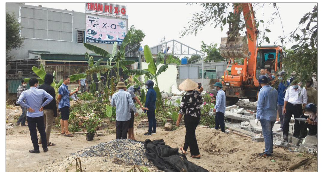
Xã Minh Lăng tiến hành cưỡng chế, thu dỡ công trình xây dựng vi phạm trên đất nông nghiệp của 1 hộ dân thôn Phú Lôi.
