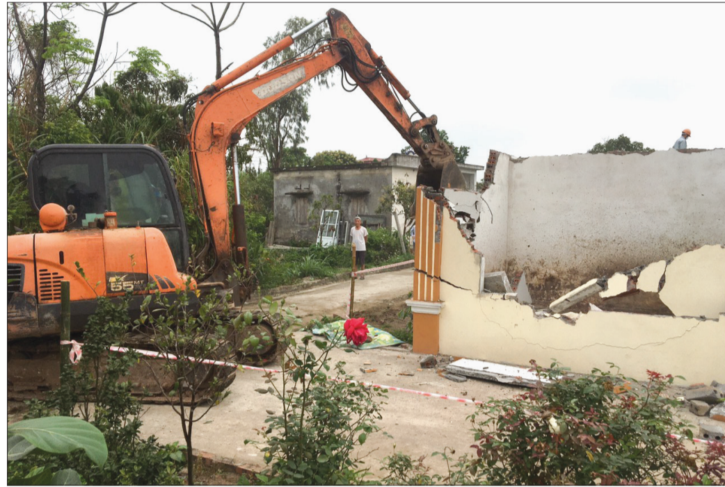
Cường chế thu dỡ công trình xây dựng nhà ở trái phép trên đất nông nghiệp của gia đình ông Nguyễn Kết Đoàn, xã Song An (Vũ Thư).
