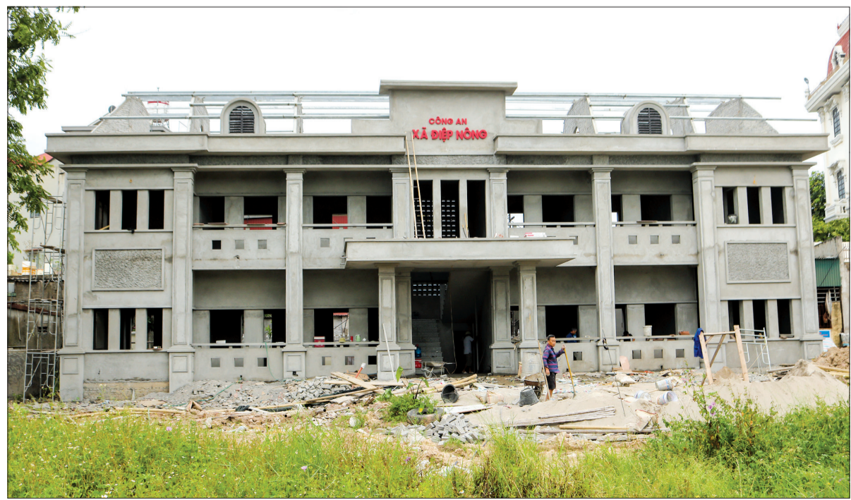
Tụ sở Công an xã Diệp Nông (Hưng Hà) đang được gấp rút hoàn thiện để đưa vào sử dụng cuối tháng 8/2023.
