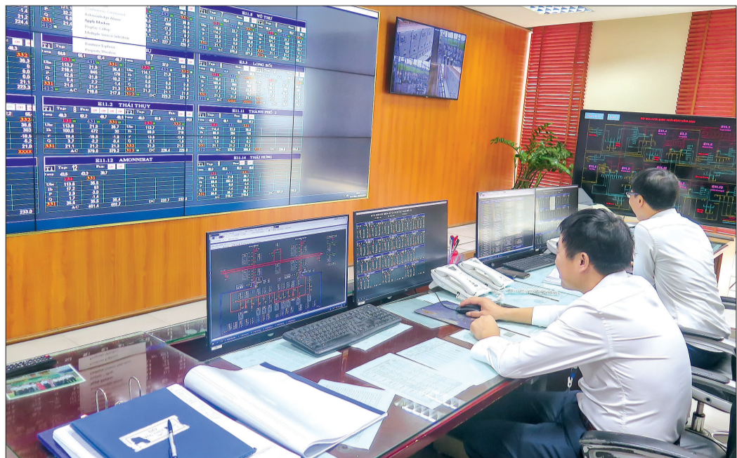
Trung tâm điều khiển xa Công ty Điện lực Thái Bình.
