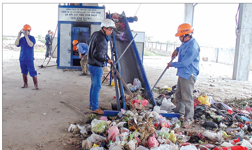
Lò đốt rác thải sinh hoạt xã Đông Xuân (Đông Hưng) hoạt động hiệu quả.
