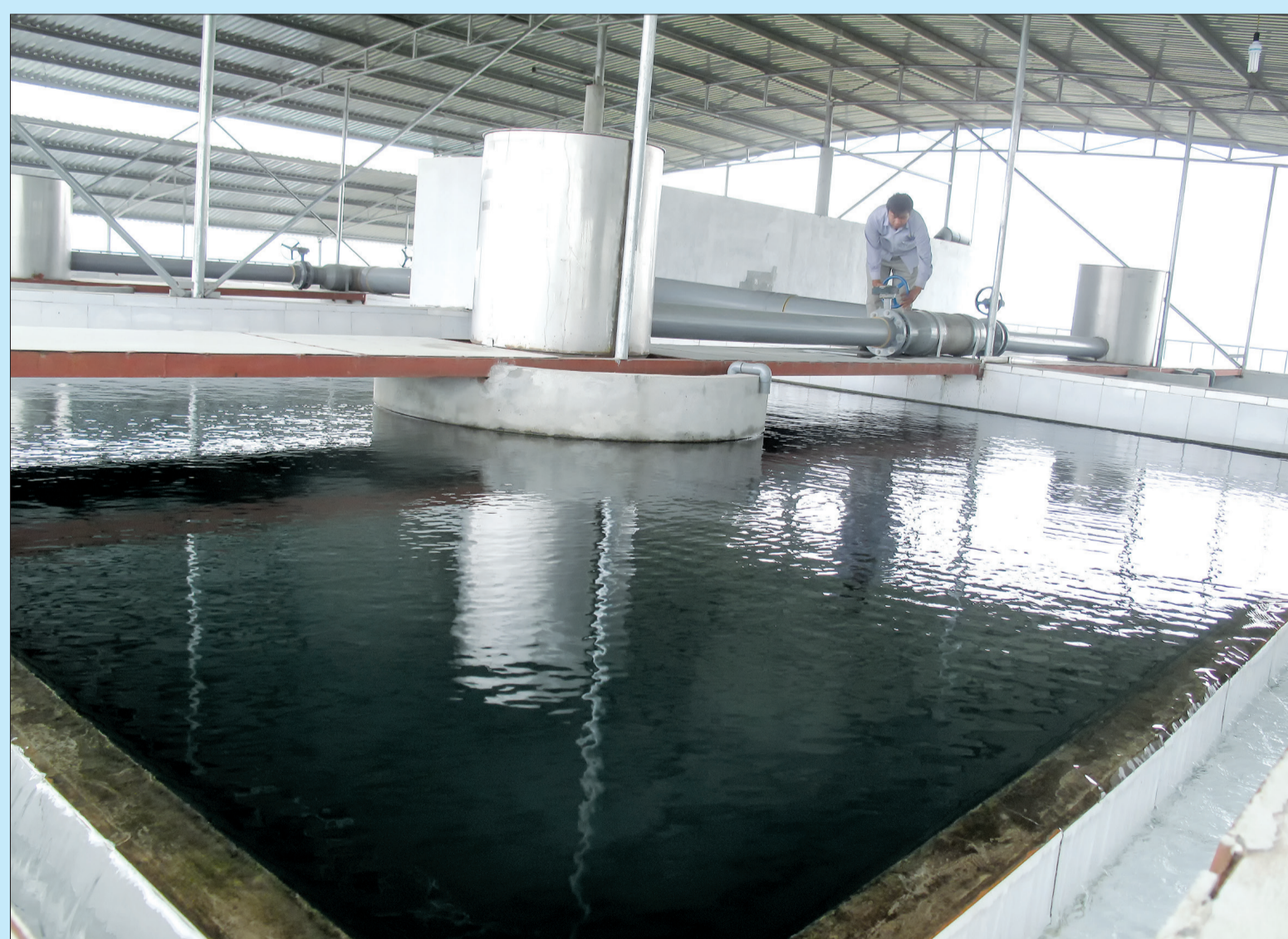
Hệ thống xử lý nước của nhà máy nước sạch Thái Dương.
