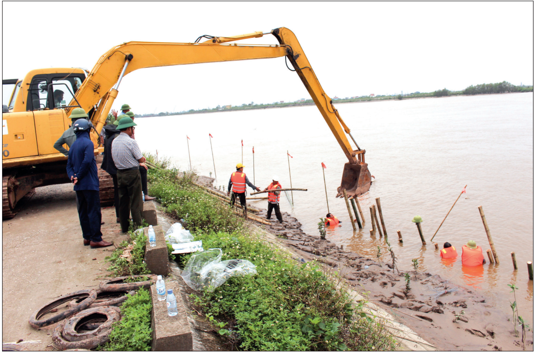
Huyện Tiền Hải xử lý sự cố sạt lở kè Nội Lang ngoài đê bồi An Hạ 2 (Nam Hải).
