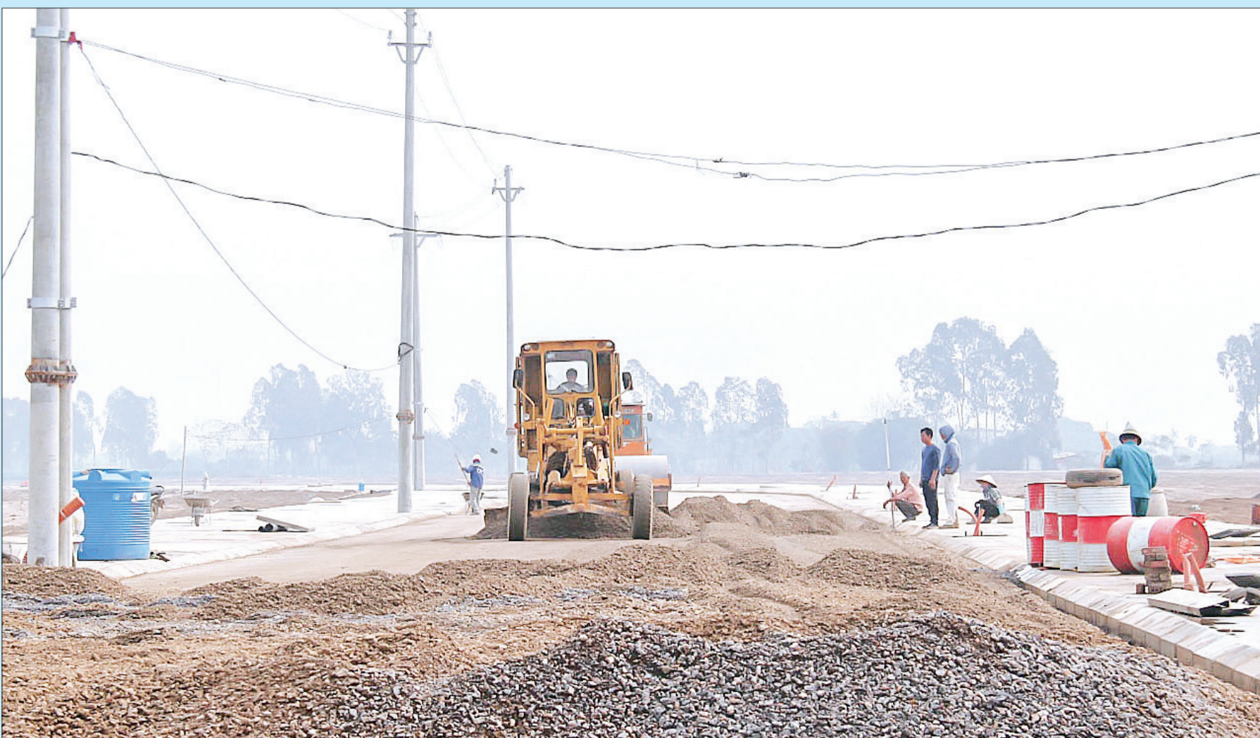
Công ty TNHH PHT Hoa Việt thi công hạ tầng cụm công nghiệp Thống Nhất.
