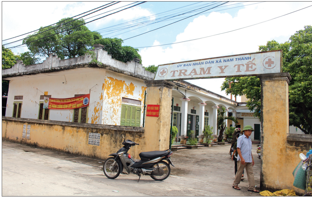
Trạm Y tế xã Nam Thanh (Tiền Hải) xây dựng cách đây gần 30 năm đang trong tình trạng xuống cấp.
