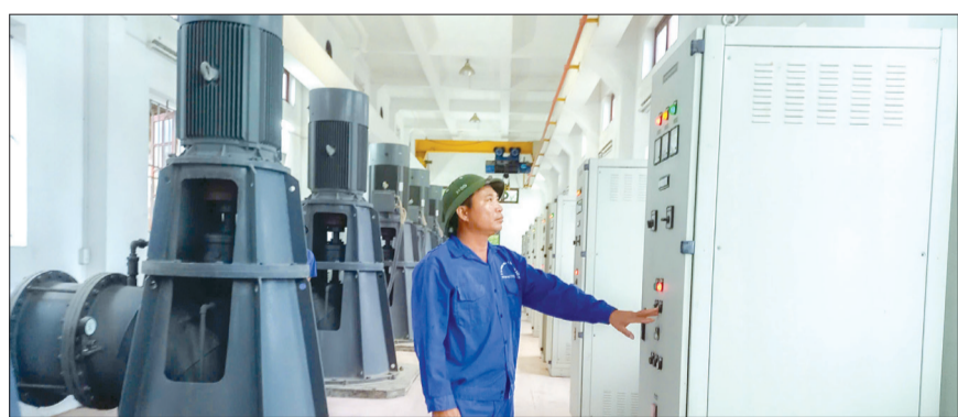
Công nhân trạm bơm Tĩnh Xuyên (Hưng Hà) kiểm tra thiết bị trước khi bơm nước đổ ải.
