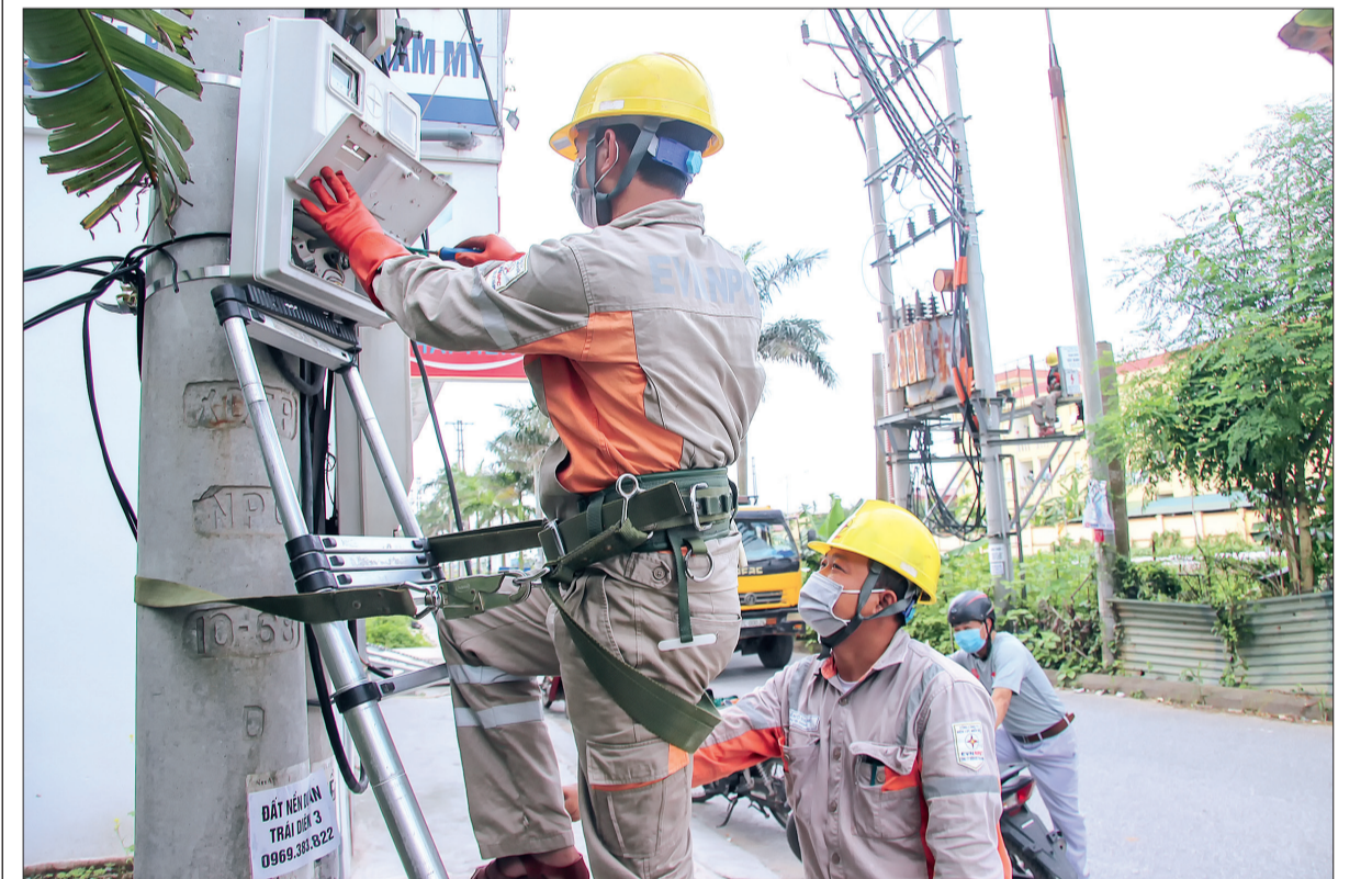
Công nhân Công ty Điện lực Thái Bình kiểm tra công tơ do điện của khách hàng.
