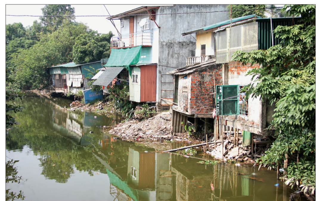
Vi phạm hành lang công trình thủy lợi trên sông Bồng Tiên, đoạn qua địa phận xã Nguyễn Xá (Vũ Thư) chưa được xử lý.
